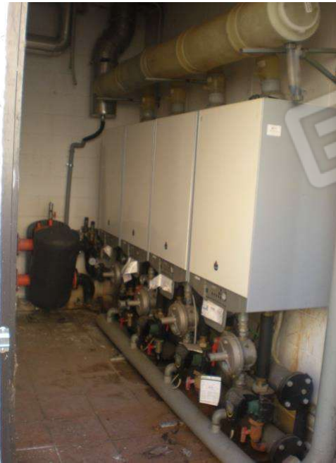
Foto 43 locale C.T. al piano terra
