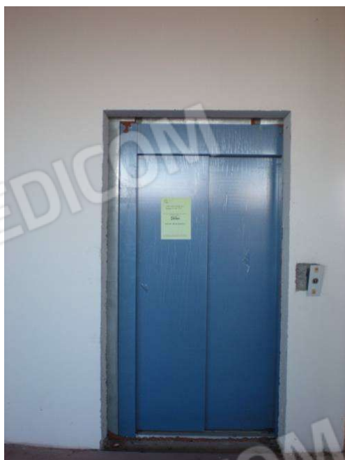
Foto 36 particolare arrivo elevatore al piano
