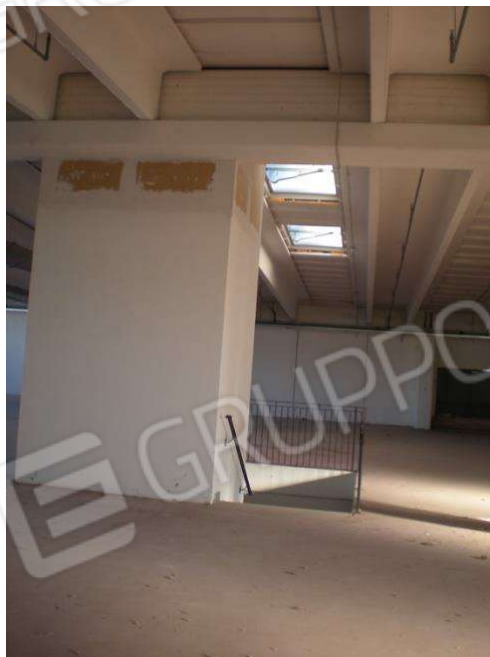
Foto 35 collegamento verticale da "spazio non accessibile"
