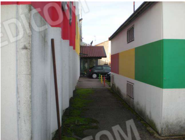
Foto 6 cabina ENEL posizione
