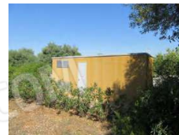
Foto da 45 a 48 – Cabina elettrica
