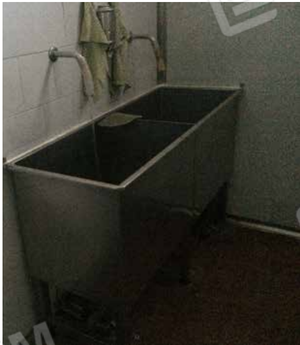
16. N. 2 vasche d'acciaio per pulizia dell'attrezzatura con pedale (Edificio A).
