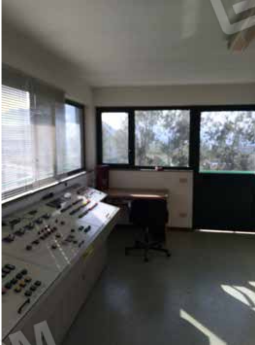
Foto.31 -Cabina di comando dell'impianto.
