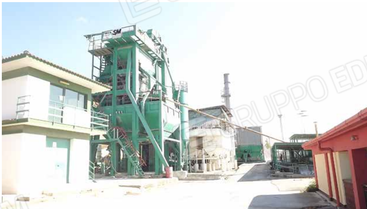
Foto.34 - Impianto di produzione di conglomerato bituminoso ed elementi strumentali all'attività dello stesso.
