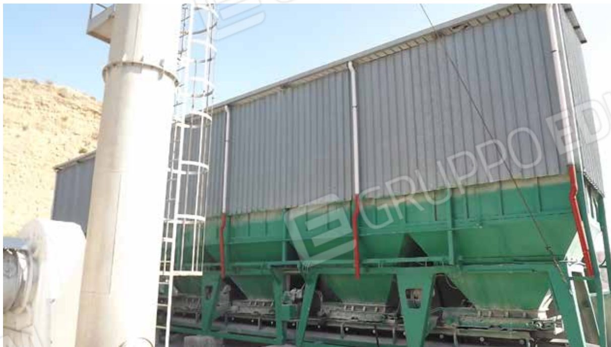
Foto.36 - Impianto di produzione di conglomerato bituminoso ed elementi strumentali all'attività dello stesso.
