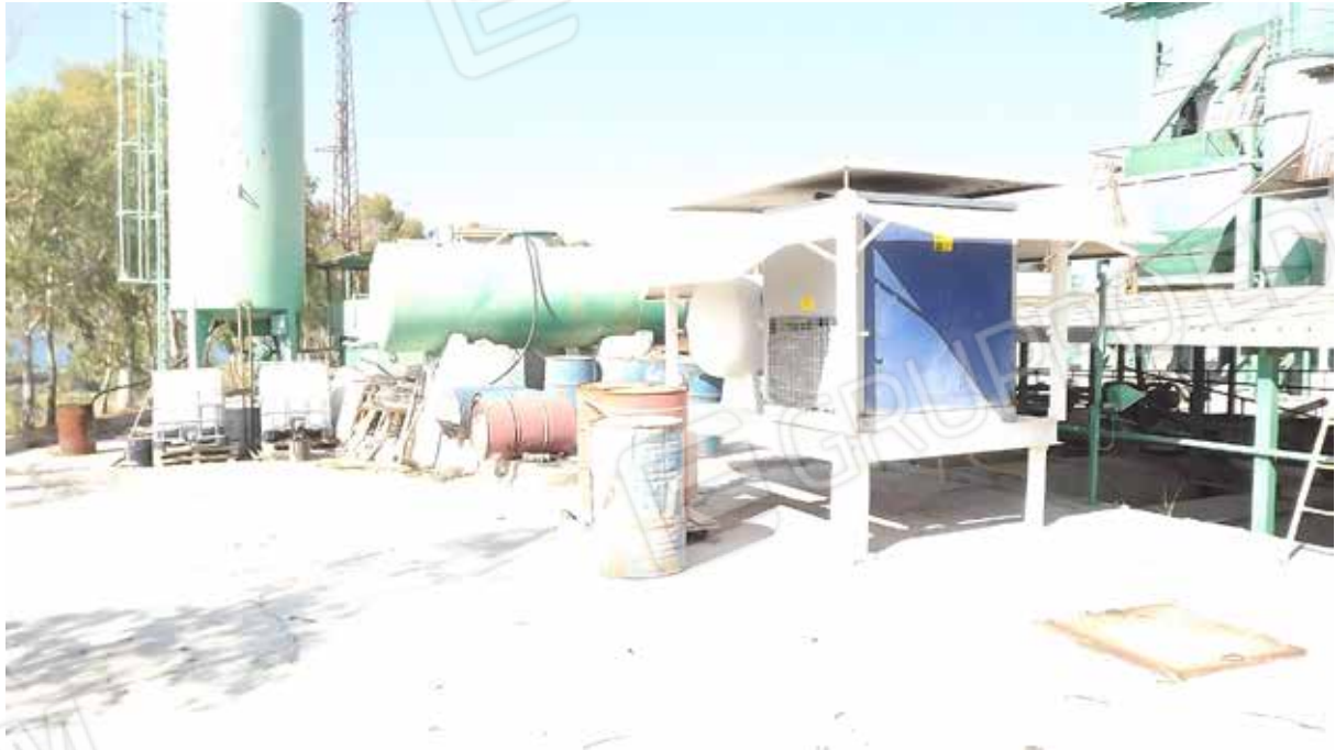
Foto.40 - Impianto di produzione di conglomerato bituminoso ed elementi strumentali all'attività dello stesso.
