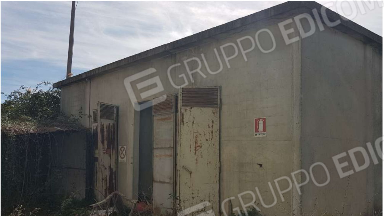
FOTO 5 vista della cabina elettrica (fg. 15-p.Ila 204-sub.3)
