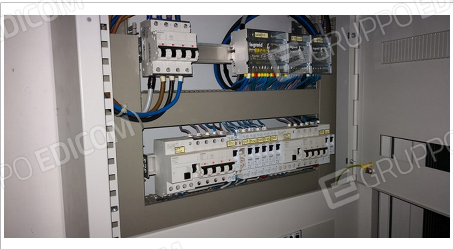
PARTICOLARE QUADRO ELETTRICO
