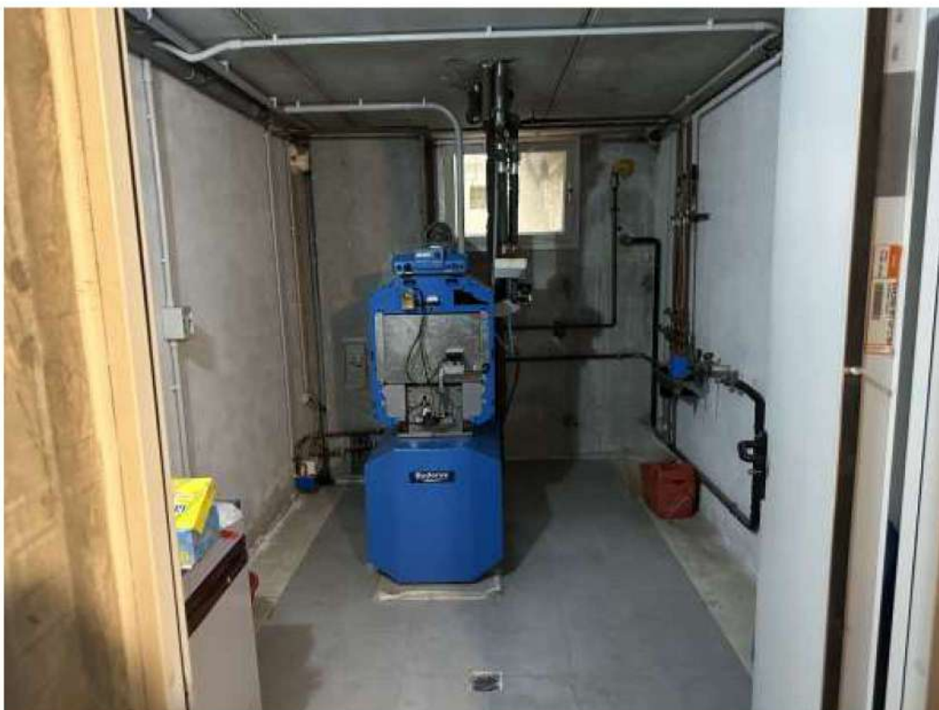
Foto 10: Piano Interrato – centrale termica
