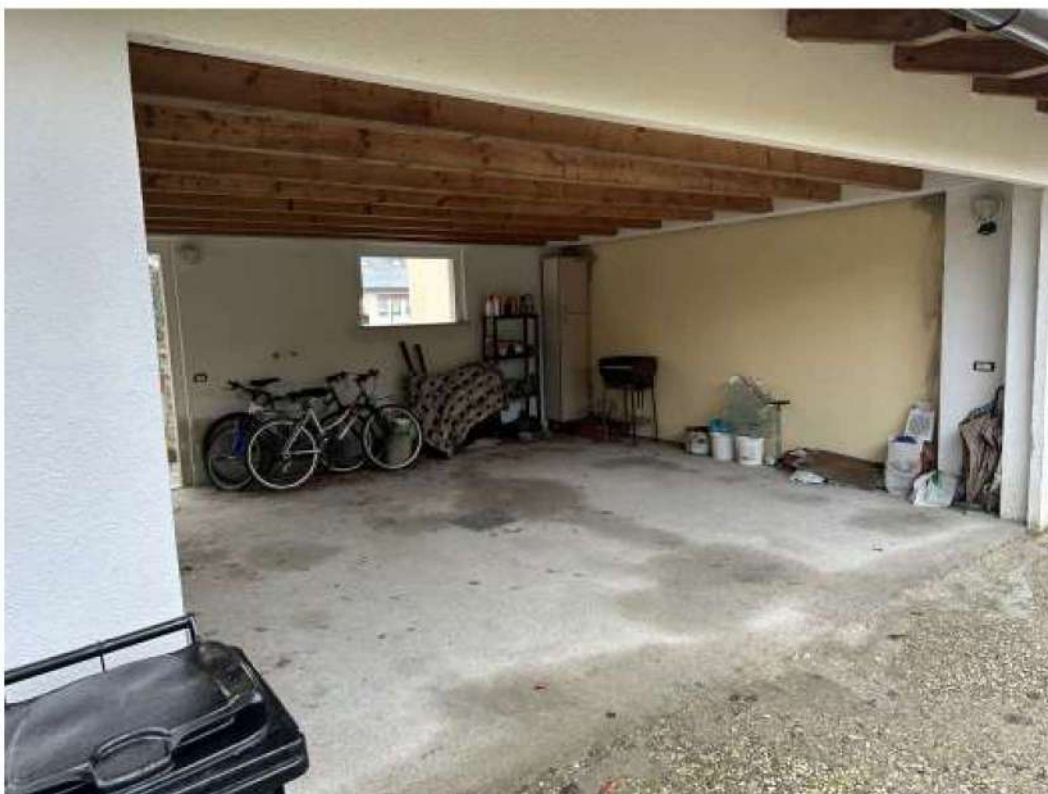
Foto 22: PT (sub. 3) – garage
