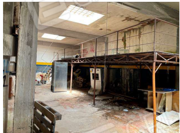
FOTO 18 – piccolo soppalco in acciaio
