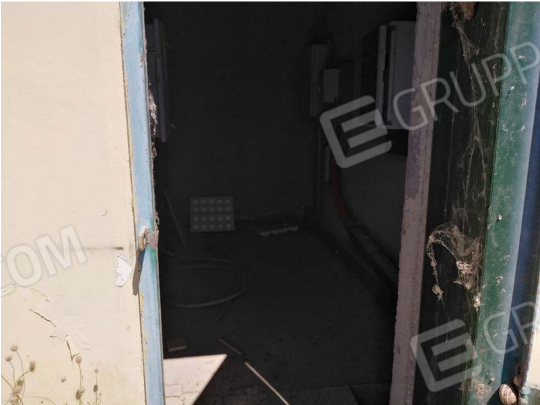
VANO CABINA ENEL
